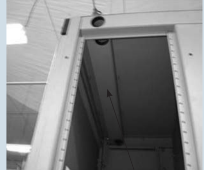
Canales de alambrado
