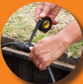
Ambientes húmedos y corrosivos
