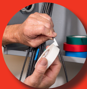
Identificación de cables
