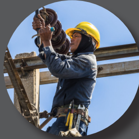
Ambientes húmedos y corrosivos
