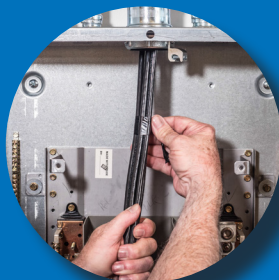
Agrupamiento temporal de cables
